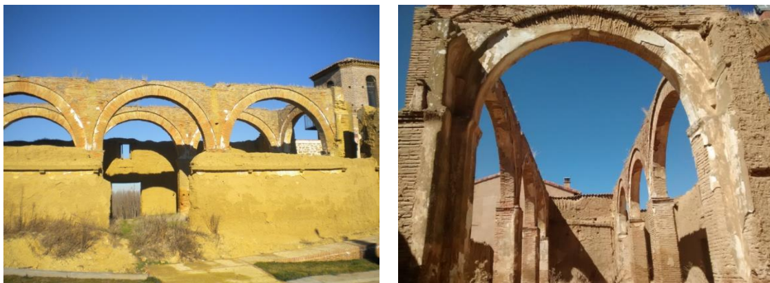
Arcos doblados de ladrillo mudéjar de separación de las naves y presbiterio de Santiago Apóstol
